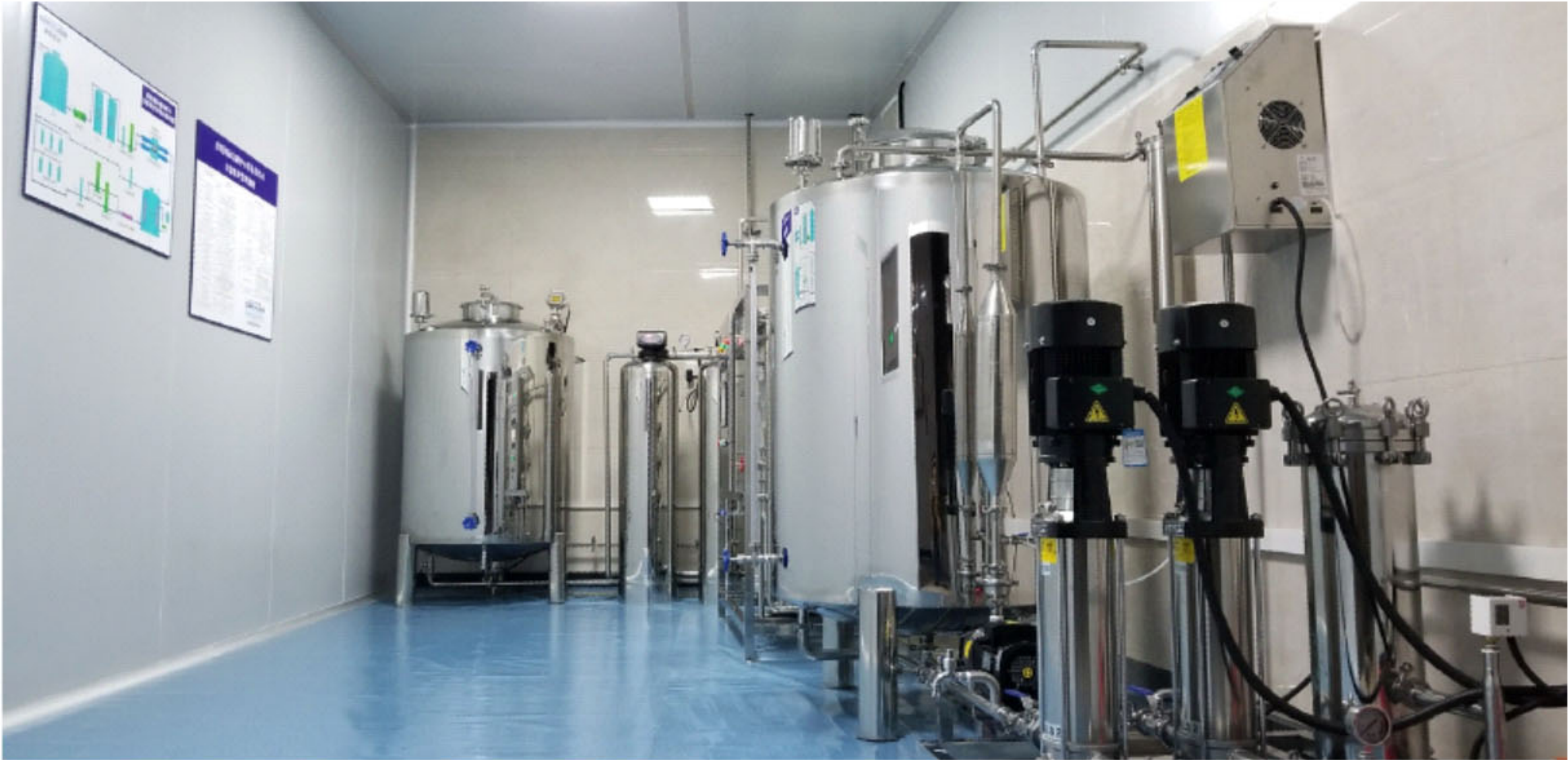
现代化直饮水机房实景图
