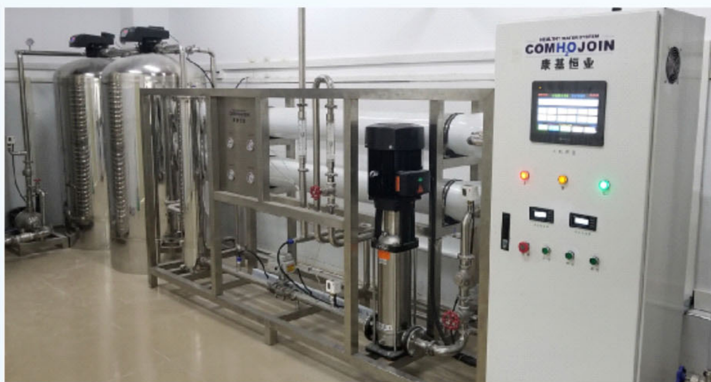
高标准建设的机房实景图
